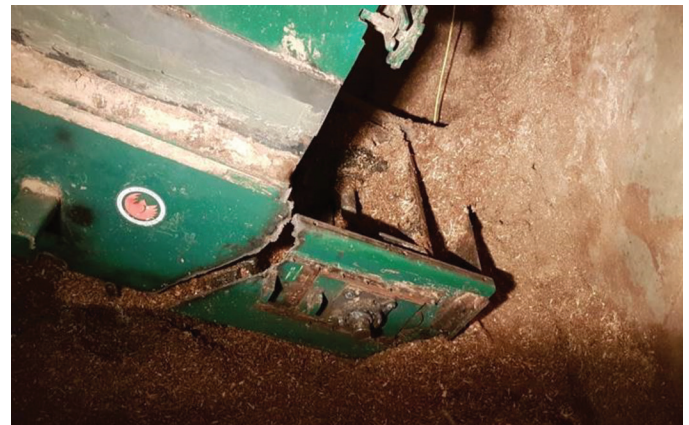
Le dispositif de protection avait été enlevé et n'avait pas été remis sur le convoyeur.
